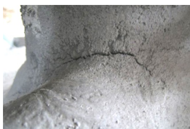
Рис. 5. Трещина, изломанная в термическом узле
