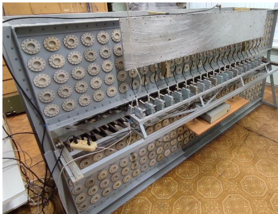
Вид со стороны коммутаторов
