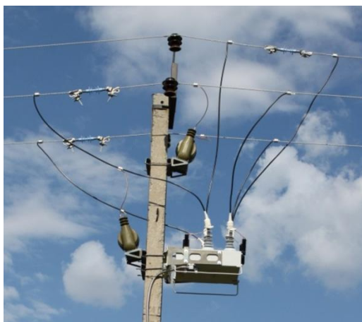
Рис. 6. Одноопорное размещение реклоузера РВА/TEL 6-10 кВ
