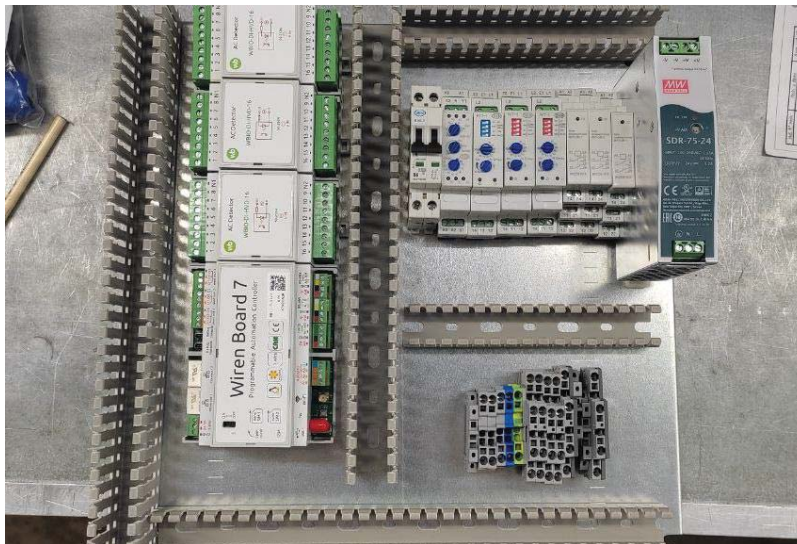
Рис. 2. Разработанный стенд на базе ПЛК WirenBoard 7
