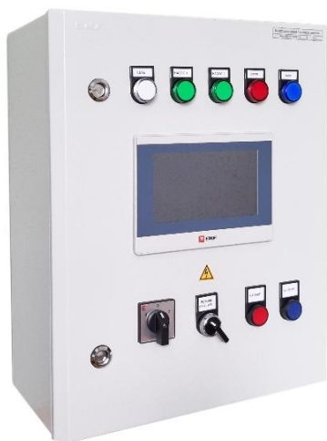
Рис. 1. Шкаф управления наружным освещением улиц города
